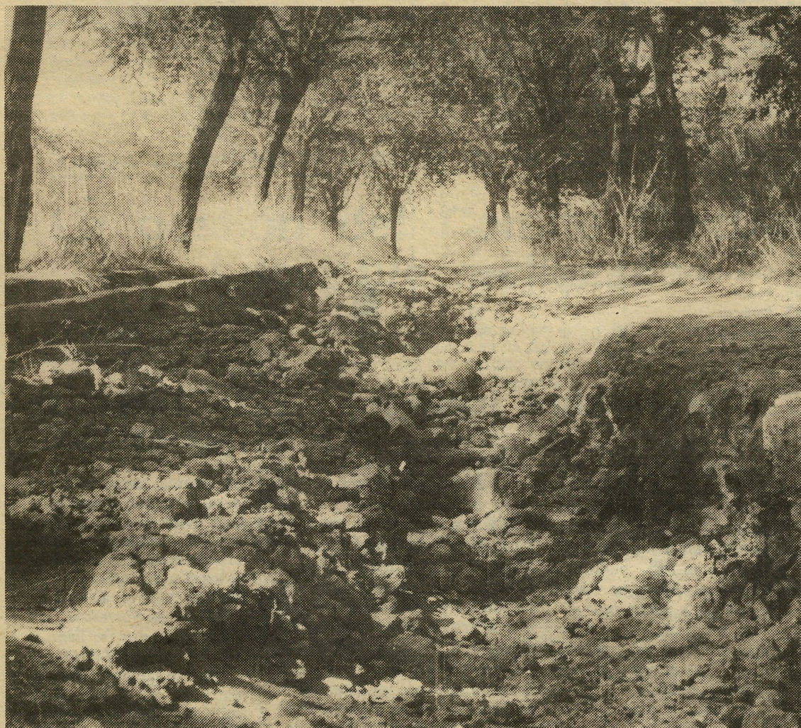
ACCESOS IMPRACTICABLES. El camino de acceso al parque de Oromana que sale de San Francisco se encuentra en el estado que recoge la foto. La acción que las lluvias y la ausencia de reparaciones y cuidados durante años lo han destrozado convirtiendo su utilización en una aventura peligrosa.
