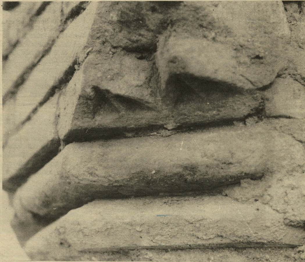
Detalle de la última columna que ha quedado en pie.
