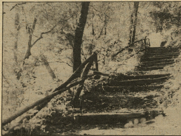
La poca consistencia de los elementos utilizados hace que lo restaurado se estropee al poco tiempo. Las barandas de este camino son un ejemplo.
