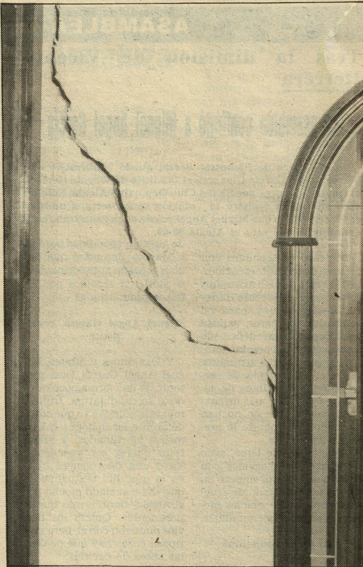
Las ostentosas grietas de las casas alarmaron a los vecinos el domingo por la noche. Foto F. TRIGO.
